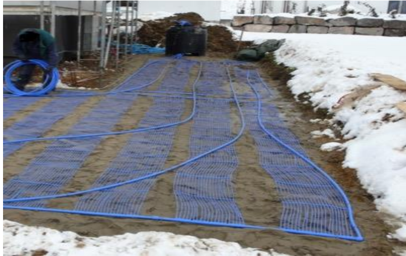
Bodennaher Flächenkollektor einer Sole-Wasser-Wärmepumpe
