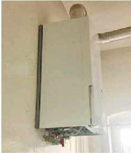
Alte Heizungstherme der Gasetagenheizung
